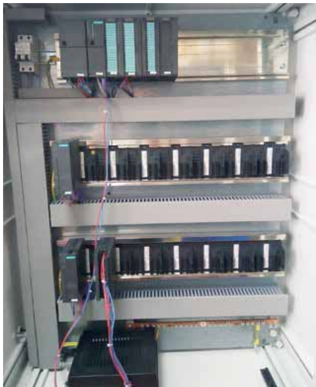
Фото 1. Стенд верификации модулей ввода-вывода контроллеров
